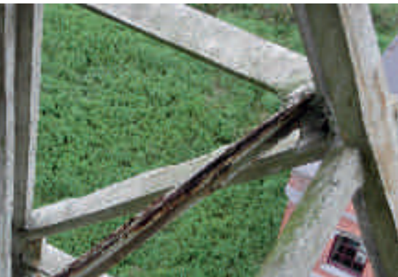
Roestend profiel drukt (te dunne) betondekking weg
