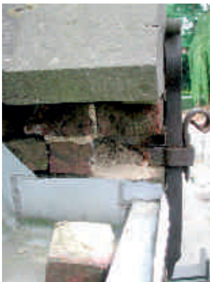
Metselwerk beschadigd door roestig muuranker
