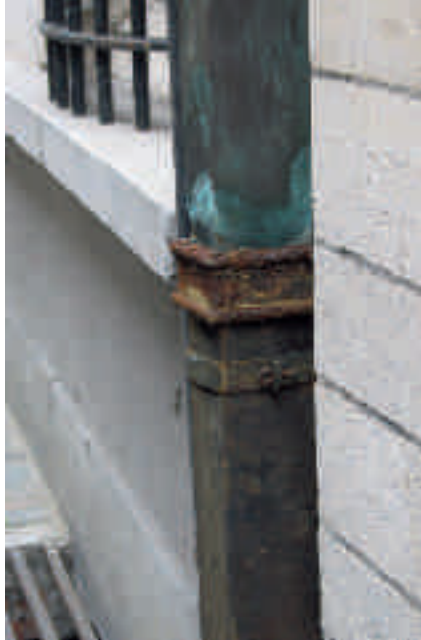
IJzer corrodeert door koperen afvoer
